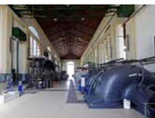
Pompe all'interno dell'Impianto Idrovoro Pilastresi
